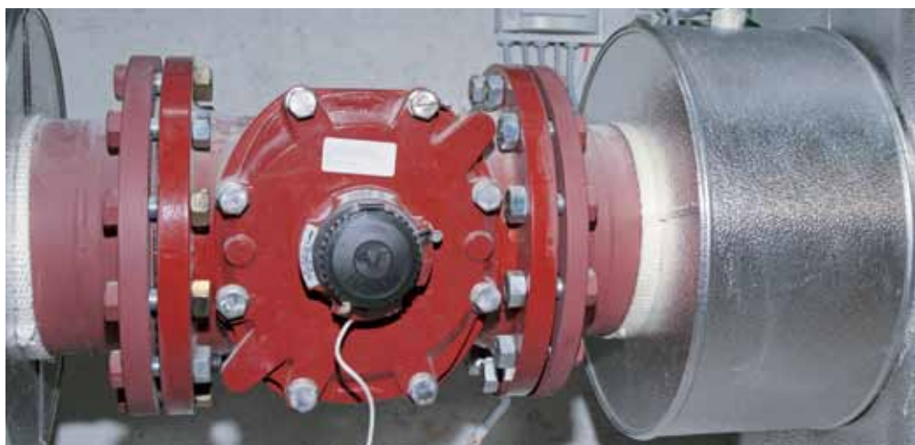
Compteur de chaleur, pompe à chaleur, quantum DN 200 pour 176 m 3 /h
