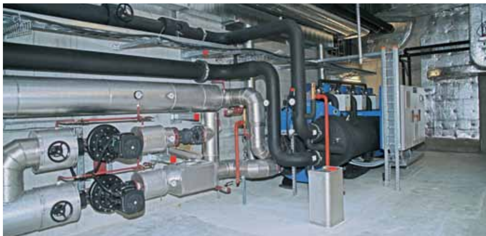
Centrales d'énergie 2ème sous-sol
